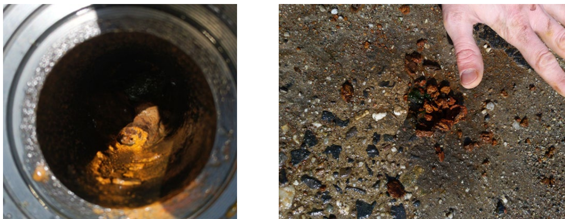
Abbildung 4.3: Ablagerungen im statischen Mischer
